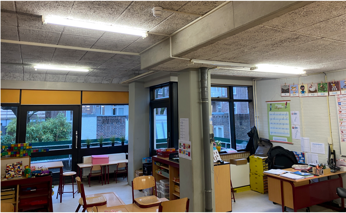
• KANALEN EN INSTALLATIES DOOR DE LOKALEN HEEN
