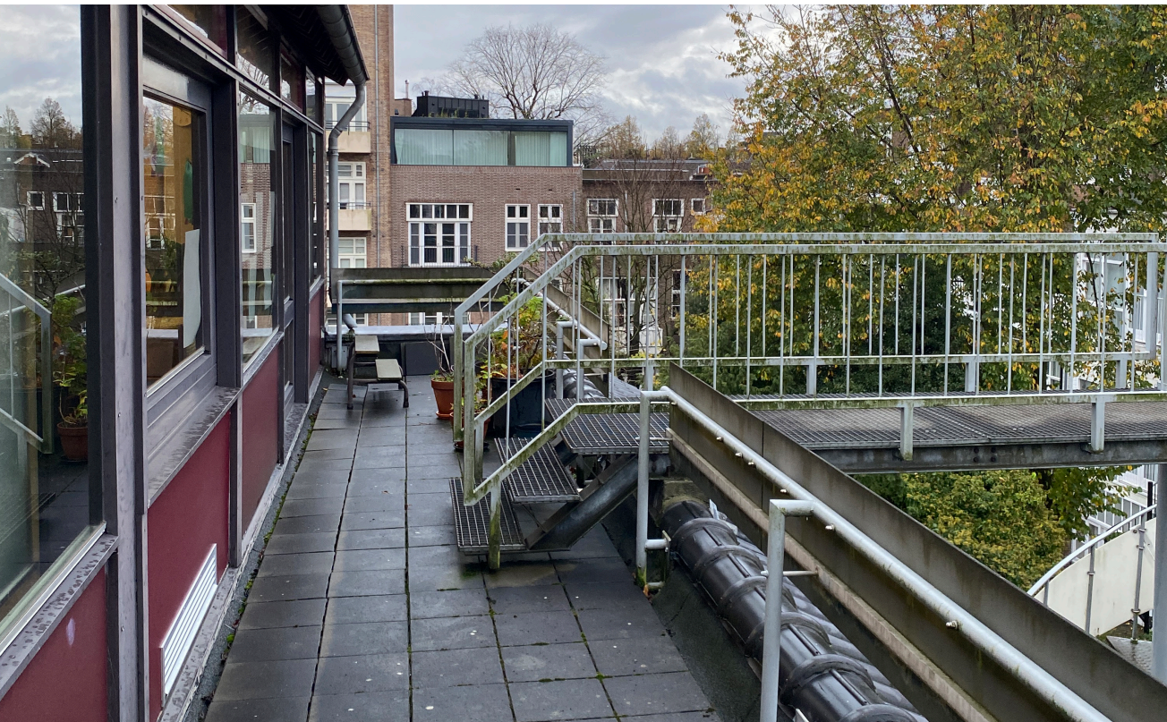
• SLECHTE ISOLATIE, ONGEBRUIKTE TERRASSEN EN VLUCHTROUTE BUITEN HET GEBOUW
