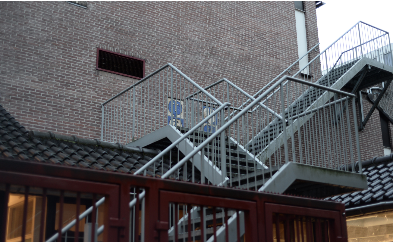
• ONLOGISCHE VLUCHTROUTE BUITEN HET GEBOUW
