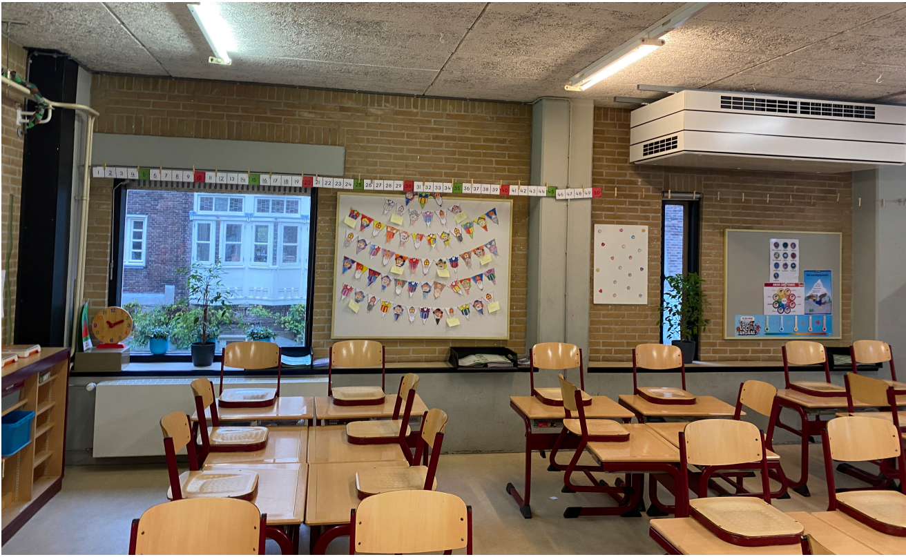
• GROTE VENTILATIE UNITS NODIG VOOR GERING COMFORT IN DE LOKALEN EN HOGE KOSTEN
